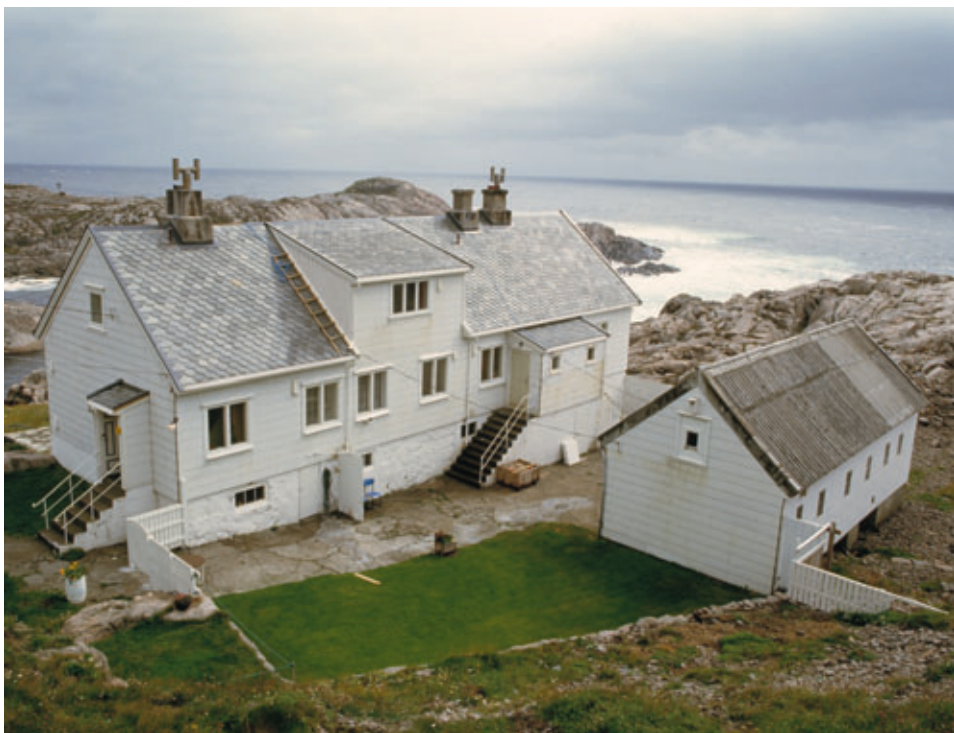
Lindesnes Fyrstasjon. Legg merke til sidebygningen, som i tillegg til eternitt fasadeplater også har bølgeeternitt på taket og eternitt vindskibeslag. Foto: Arve Kjersheim©Riksantikvaren.
