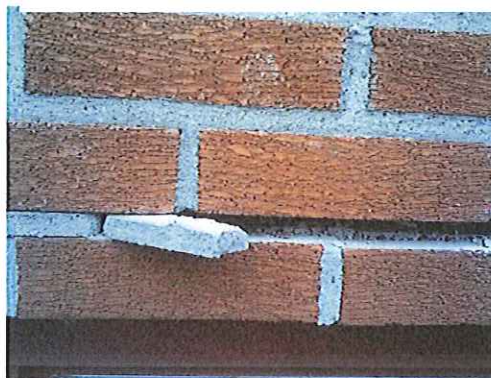
Fig 12 Fasade med innmurt armering som korroderer. (Multiconsult AS)
