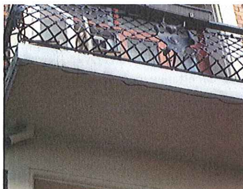
Fig 11 Sprekker i puss rundt innmurt stålramme i balkong. (Multiconsult AS)
