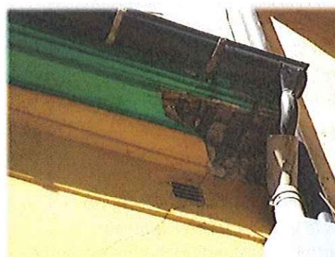
Fig 9 Trekning/ utsmykning gesims. Flere steiner fra trekning har falt ned. (Multiconsult AS)
